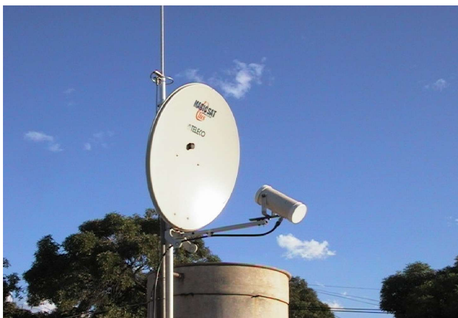
Antena terminada, instalada y apuntada.
